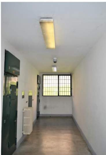
Telecamera n°72 isolamento lato B
